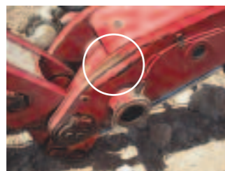
Endommagement dû à un écoulement extérieur entraînant des dommages ultérieurs (fissure)
