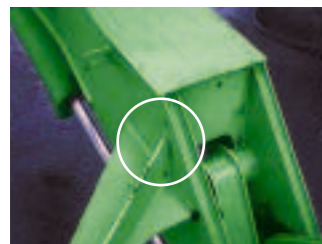
Formation d'une fissure sur le support de tuyau
