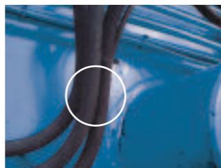
Lors de son contrôle, l'expert n'a constaté qu'un défaut de peinture
