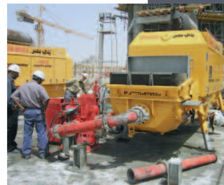
Vue d'une des pompes super haute pression BSA 14000 SHP-D sur laquelle est raccordée une tuyauterie de transport très balastée. A gauche sur la photographie une guillotine massive
