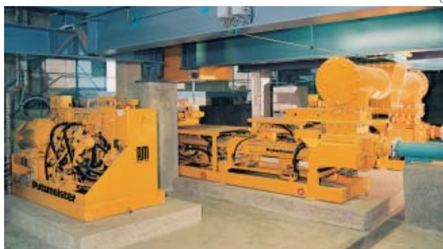
2 pompes KOS 1030 à matières épaisses pour injecter les boues d'épuration dans l'incinérateur d'ordures ménagères de DINAN (en France)
